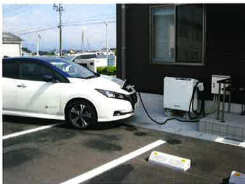
電気自動車へ充電中
