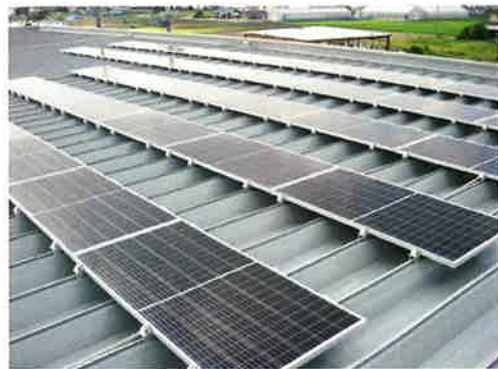
社屋の屋根に設置したソーラーパネル
